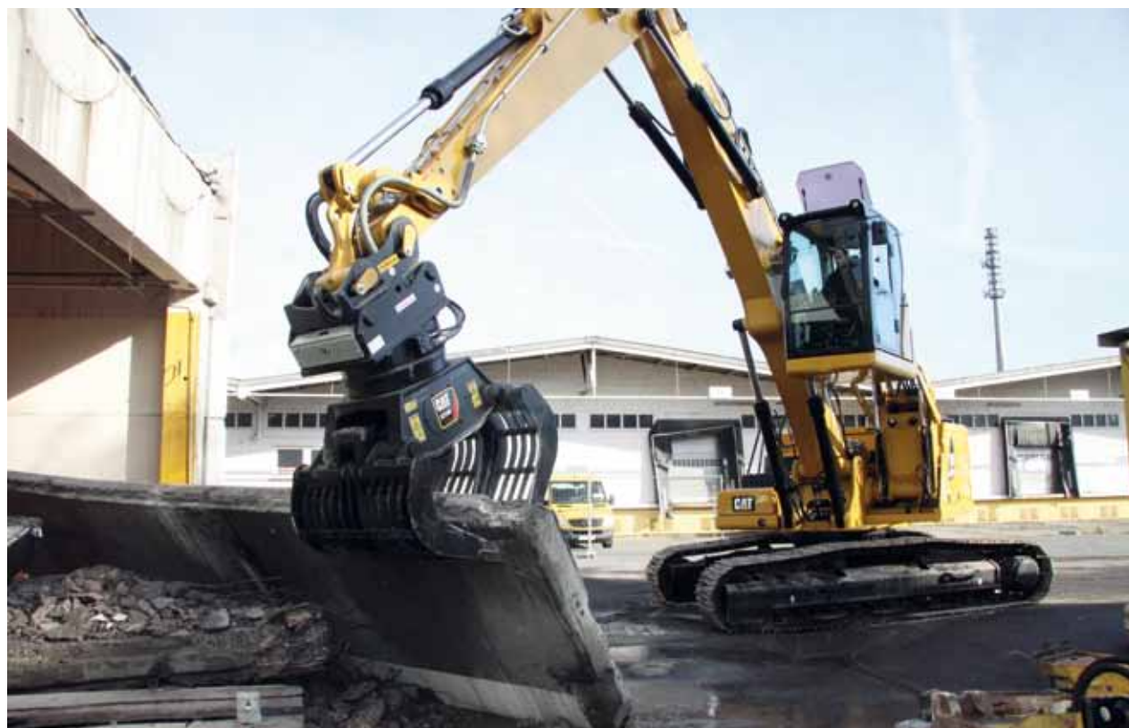
Mit dem Cat 330MH lassen sich Sortierarbeiten übernehmen, wie sie für den Rückbau auf dem ehemaligen Grundig-Areal anstehen. Fotos: Zeppelin
