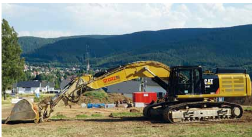
Wohnen mit Blick auf eine Weltcup-Schanze: In Neustadt im Schwarzwald ist das bald möglich. Der schwere Cat Kettenbagger 349E erledigt die nötigen Erdarbeiten. Foto: Storz
