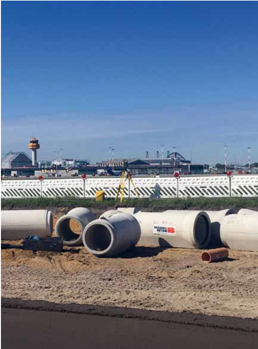
Die Firmen Groth und Kemna Bau Andreae arbeiten derzeit am zweiten Bauabschnitt und liegen nicht zuletzt aufgrund der präzisen 3D-Maschinensteuerung von Trimble für Fertiger und Bagger voll im Zeitplan. Fotos: Sitech
