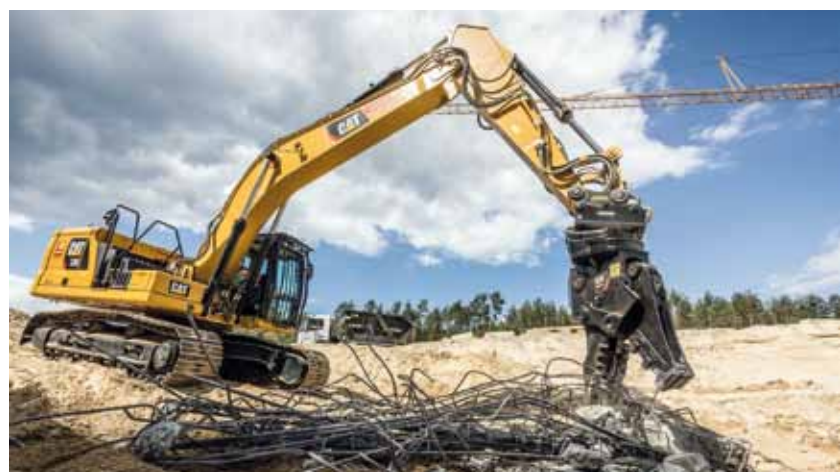
Ein Cat Kettenbagger 330 beißt sich durch die Überbleibsel der alten Eisenbahnbrücke. Fotos: x21de – Reiner Freese
