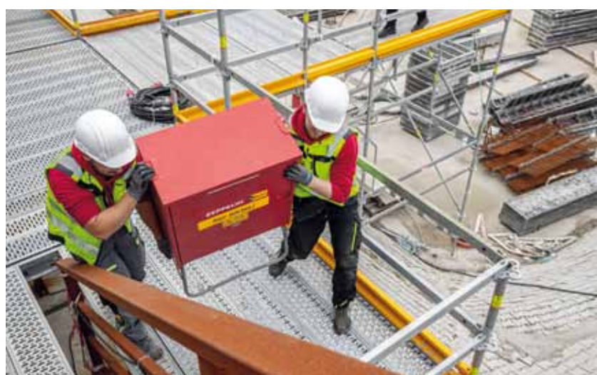
Im Laufe des Bauvorhabens werden bis zu 170 Baustromverteiler auf dem Baufeld benötigt.
