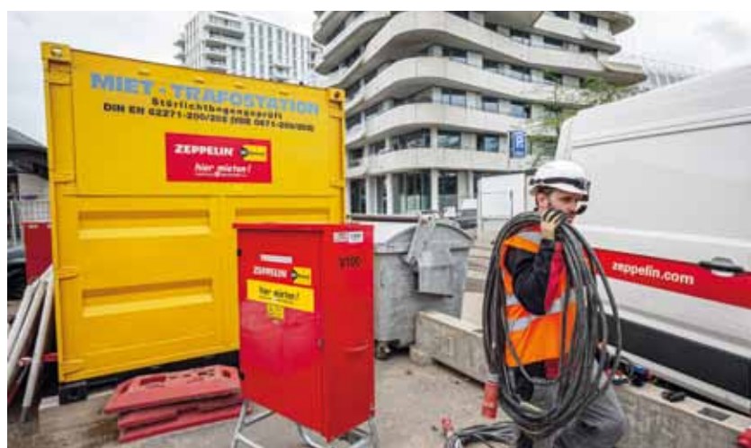
Eine Trafostation transformiert die Spannung von 10 000 auf 400 Volt.
