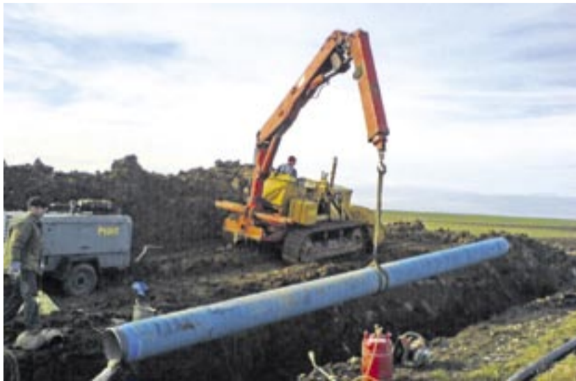
Mit der Cat Laderaupen 977H werden selbst heute noch Trinkwasserrohre von der Gustav Schäfer GmbH & Co. KG verlegt. Foto: Schäfer
