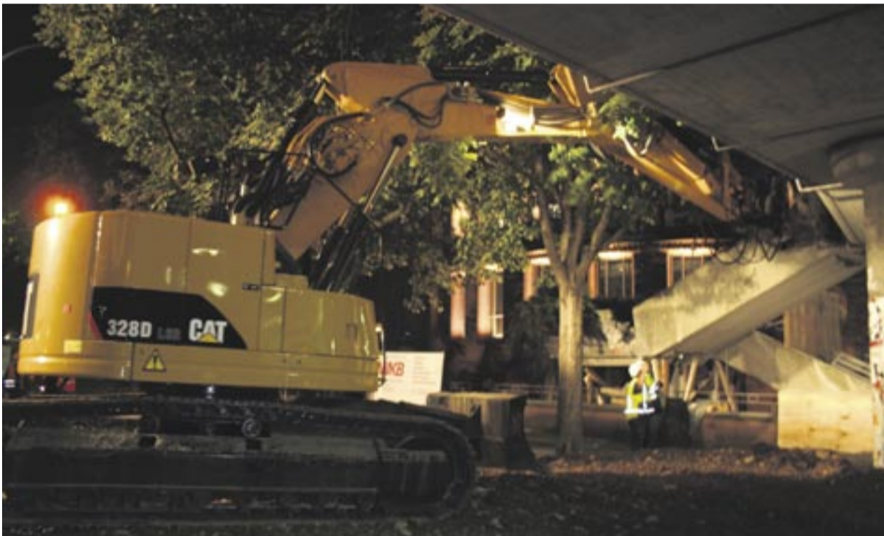
Kam dem Abbruchunternehmen gerade Recht: der Cat 328DLNCR mit Kurzheck und seinem hydraulisch verstellbaren Ausleger.
