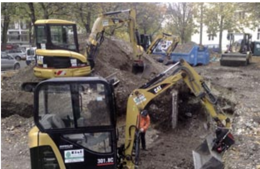
Bevor der Galabauer Eisl mit der Gestaltung des Habsburgerplatzes beginnen konnte, mussten Cat Baumaschinen erst den Luftschutzbunker samt seiner Hohlräume entfernen.
