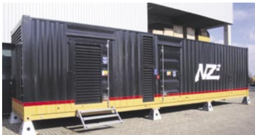
Unterstützt die Luftstreitkräfte der Tschechischen Republik: das stationäre Notstromaggregat von Phoenix-Zeppelin. Foto: Phoenix-Zeppelin
