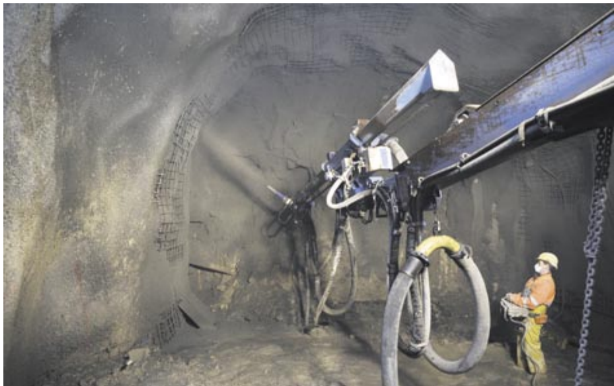
Im Salzbergwerk Stetten wird der polymer-vergütete Spritzbeton auf die Wände aufgetragen, um den neuen Tunnel zu stabilisieren und abzudichten. Foto: Wacker Chemie
