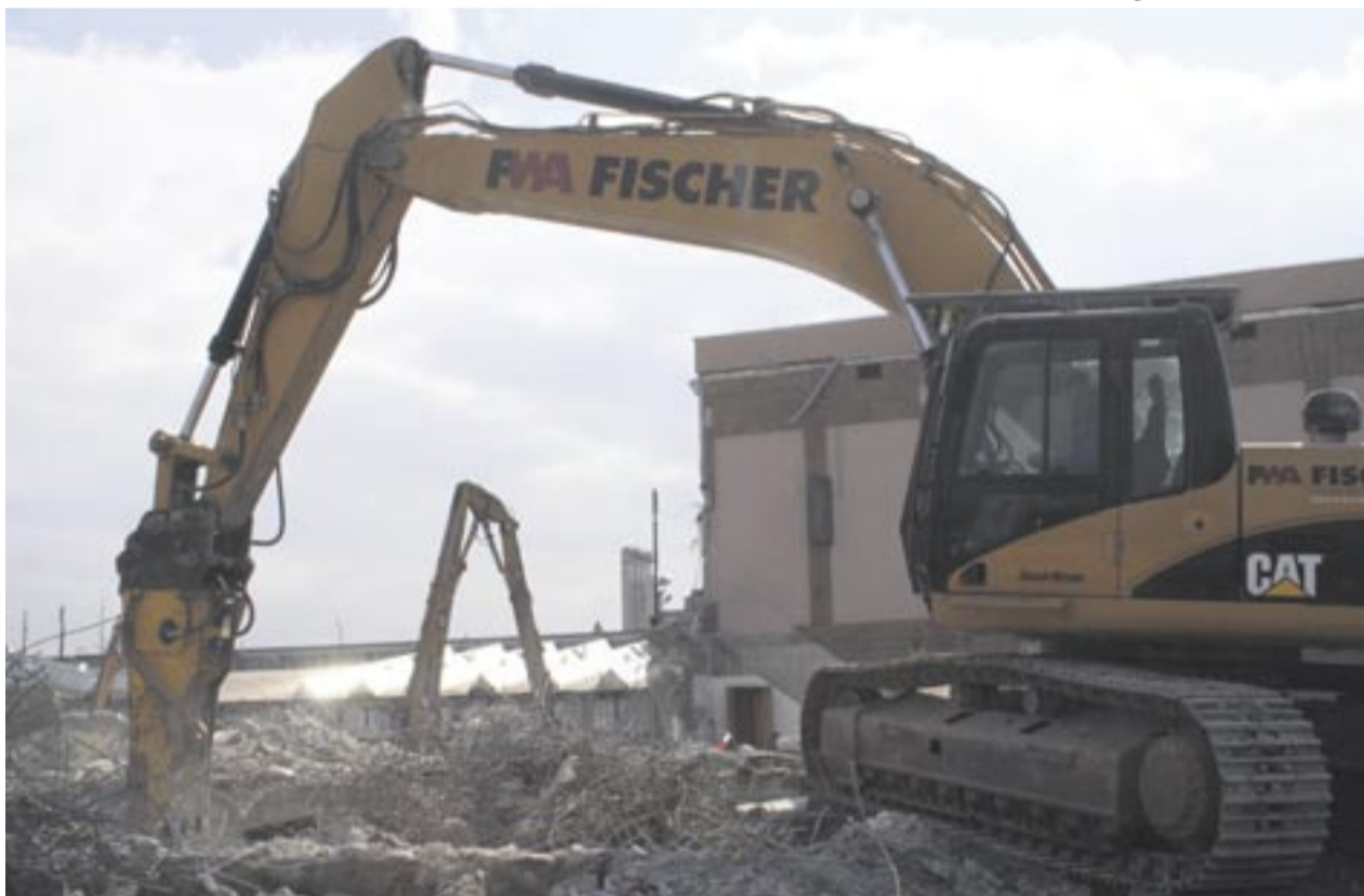
Die Abbruchspezialisten machen der alten Messe Stuttgart mit zahlreichen Cat Baumaschinen den Garaus.
