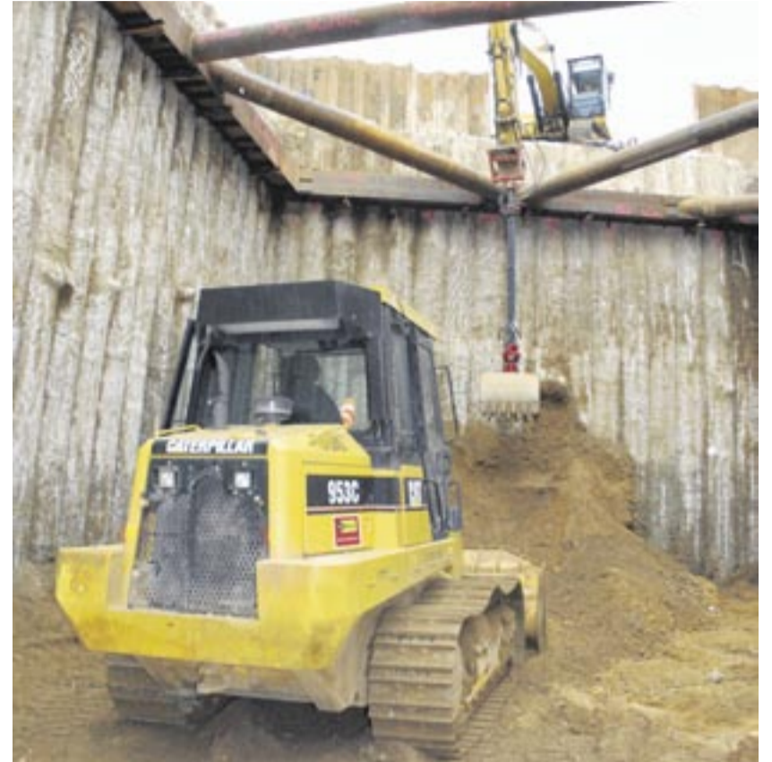
Arbeit in der Tiefe: In der Grube schiebt der Cat Kettenlader 953C alles auszuhebende Material auf eine Sammelstelle, die für den Cat 325D LN erreichbar ist.
