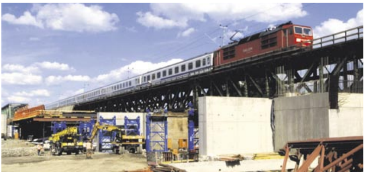
Um die Eisenbahnverbindung möglichst lange aufrecht zu erhalten, wurden die Vorlandbrücken der neuen Oderbrücke an beiden Ufern auf einer Traggerüstkonstruktion vorgefertigt. Foto: RöRo Traggerüstsysteme
