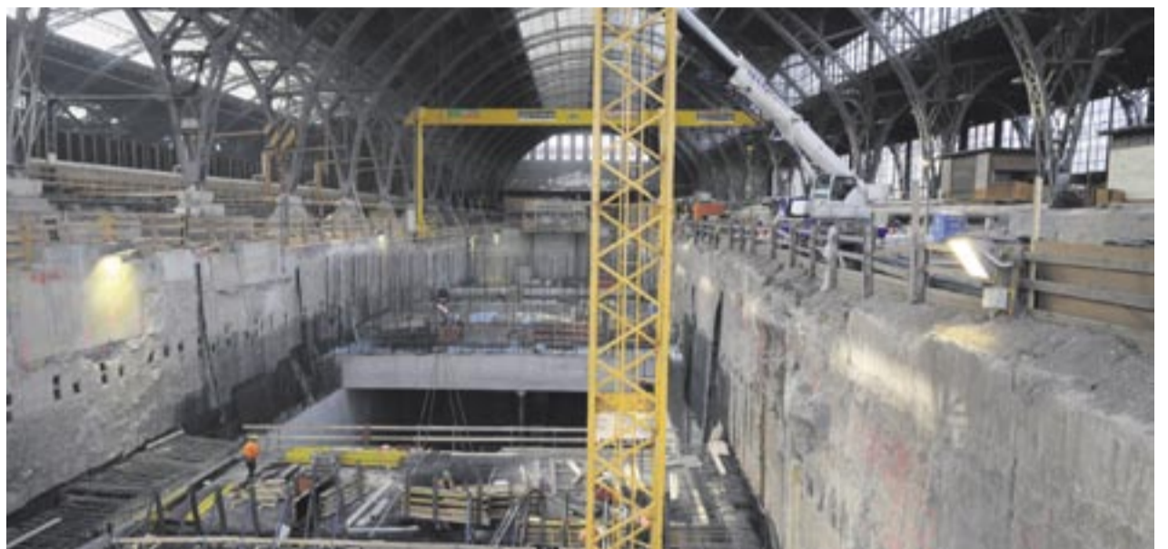
Nicht nur die Ingenieure und Arbeiter müssen Höchstleistungen vollbringen, sondern auch alle beim Bau des City-Tunnel Leipzigs eingesetzten Maschinen werden bis zum Maximum beansprucht. Foto: DeWalt
