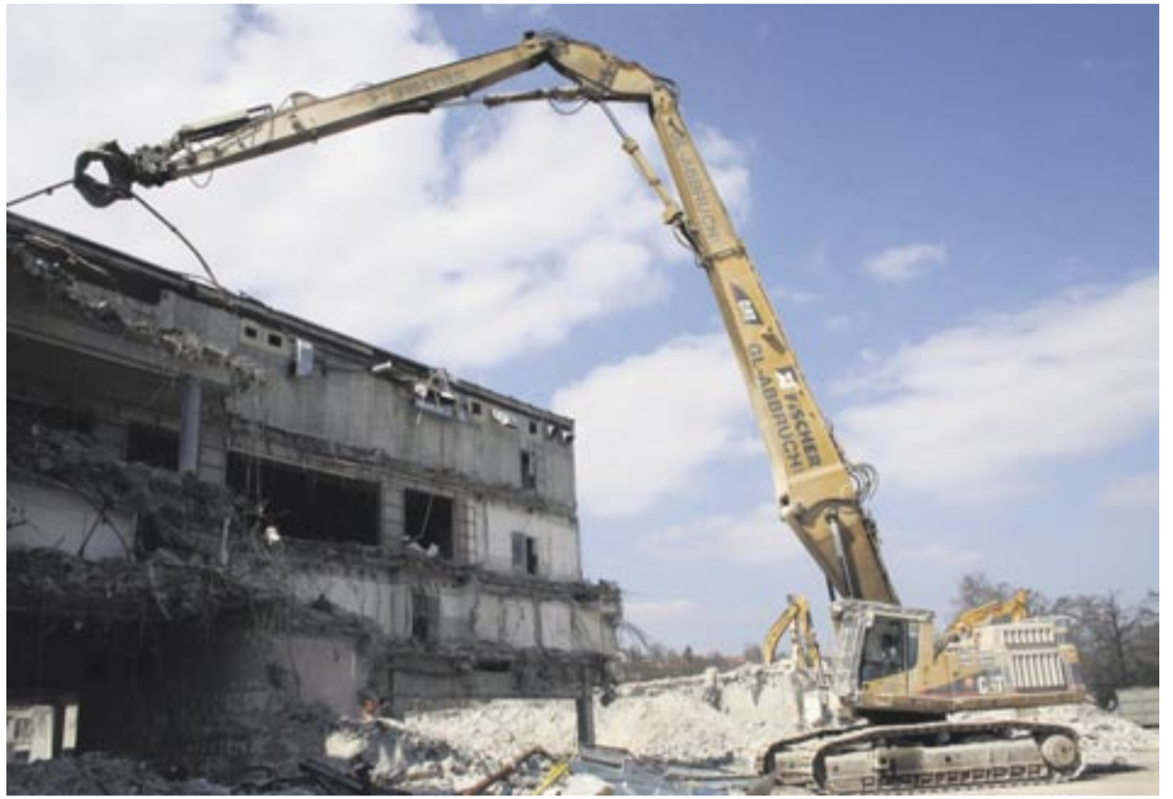
Um die 24 Meter hohen Hallenbauten zu Fall zu bringen, setzt GL Abbruch auf dem Gelände zwei Cat Longfrontbagger, wie einen 365B und 330D ein. Fotos: Zeppelin
