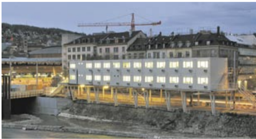
Die 26 Module der Alho-Basic-Line wurden am Züricher Bahnhof auf einer über drei Meter hohen Stahl-Unterkonstruktion montiert.
