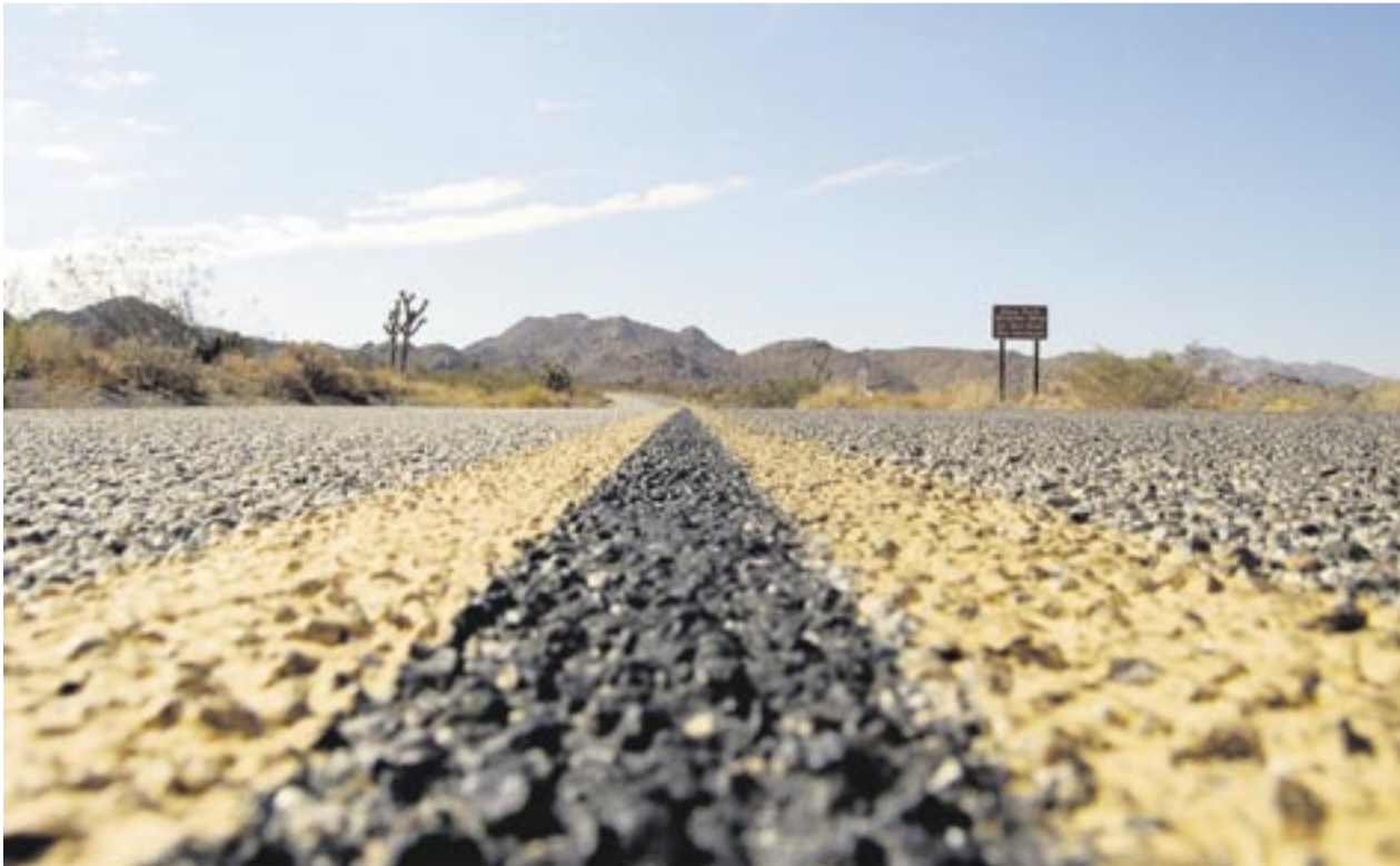
Ein Drittel aller Straßen befindet sich in einem schlechten Zustand.
