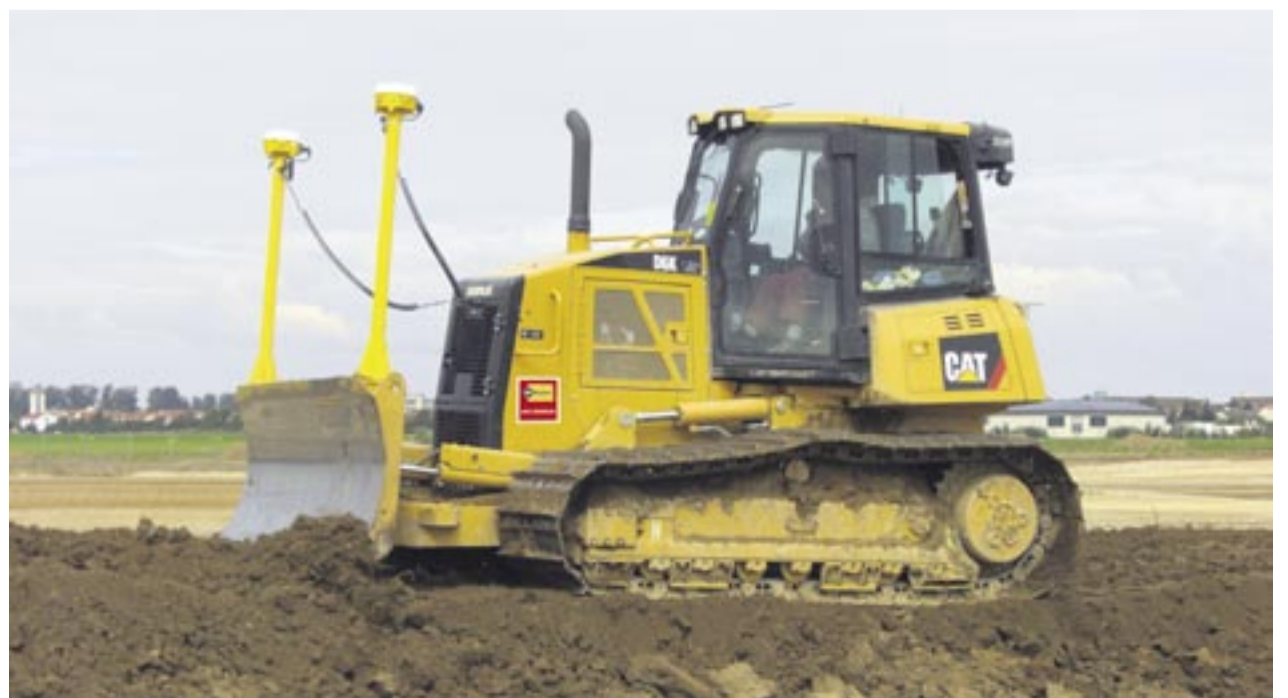
GPS-Steuerung für zentimetergenaues Arbeiten: Ausgestattet mit dieser modernen Maschinensteuerungstechnik tragen vier Dozer aus der MVS-Zeppelin-Mietflotte – hier im Bild ein Cat D6K – profiligerecht den Oberboden vom Gelände ab. Foto: MVS Zeppelin
