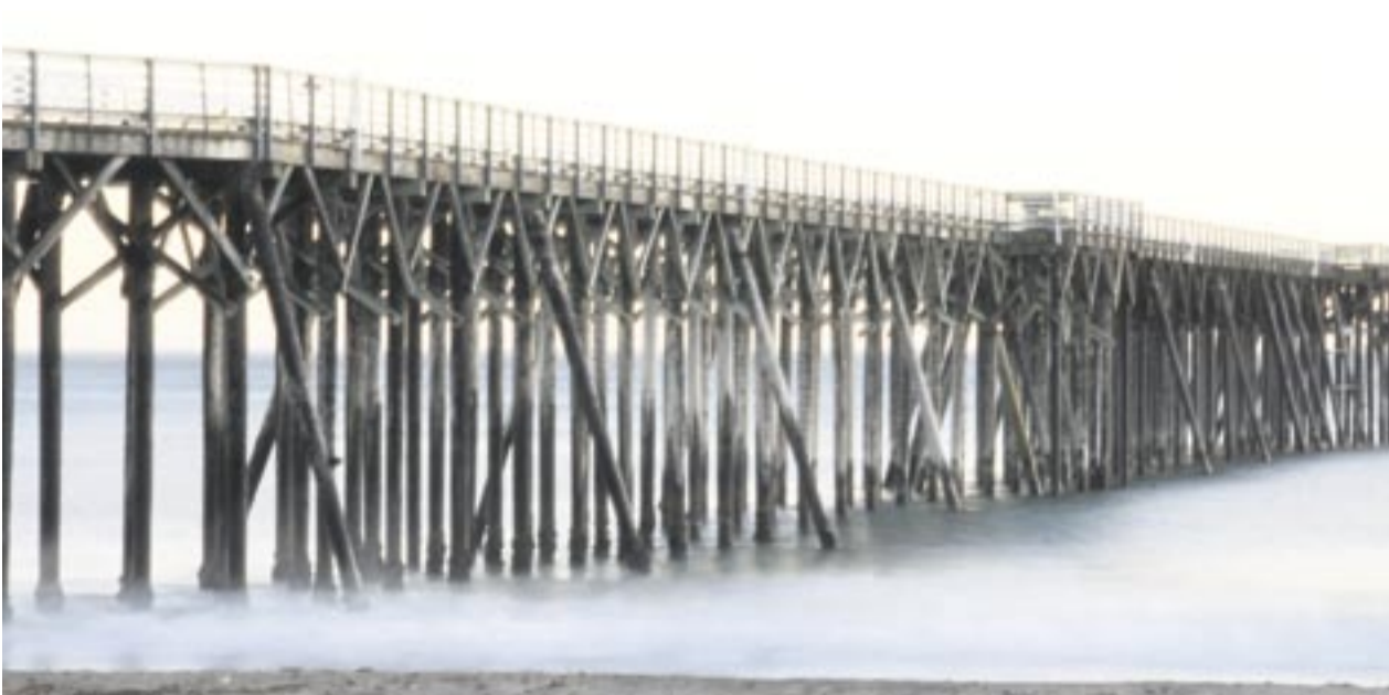
Über 26 Prozent der Brücken sind akut sanierungsbedürftig.
