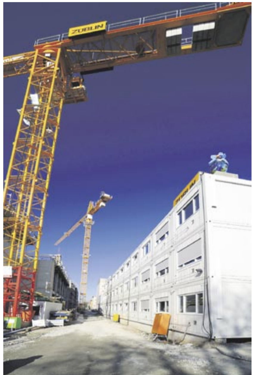
72 Alho-Basic-Line-Container bilden die Baustelleneinrichtung für die Stadtgalerie in Schweinfurt, die von Züblin gebaut wird. Fotos: Alho
