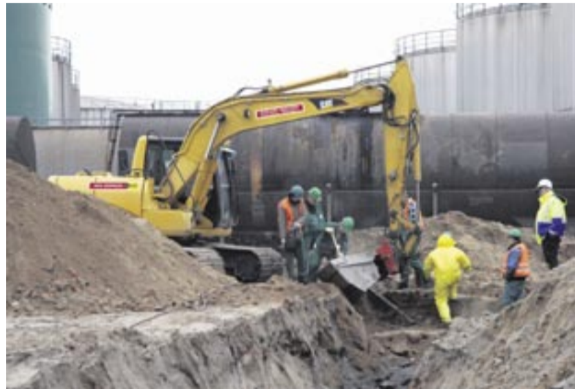
Mit äußerster Sorgfalt und Präzision trägt der Kettenbagger die etwa einen Meter dicken Verfüllungen ab und macht den Untergrund so für eine Sondierung in der Tiefe zugänglich. Foto: MVS Zeppelin
