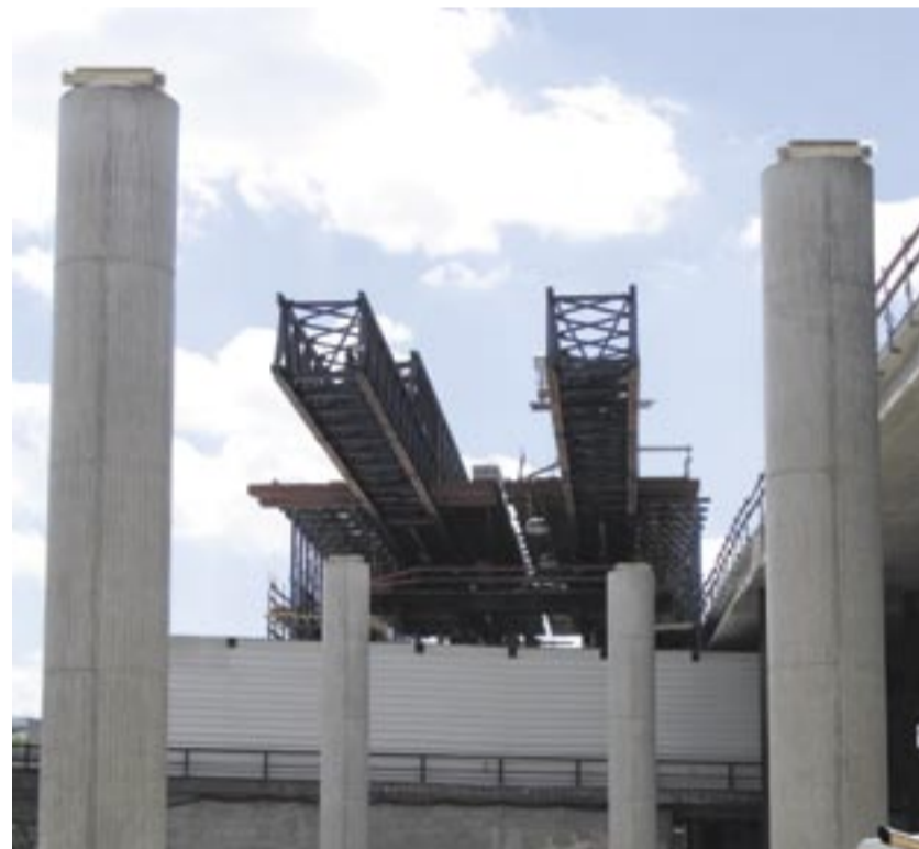
Die einzelnen Elemente der Brückenplatte werden mit der Vorschubrüstung hergestellt. Fotos: Deutsches Baublatt
