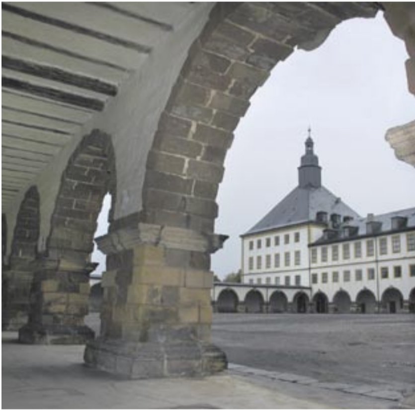
Der Zahn der Zeit nagt an den historischen Pfeilern des Arkadenrundgangs von Schloss Friedenstein. Nach Abschluss des DBU-geförderten Projektes ist nun der Weg für die Pfeiler-Sanierung frei. Foto: © Stiftung Thüringer Schlösser und Gärten
