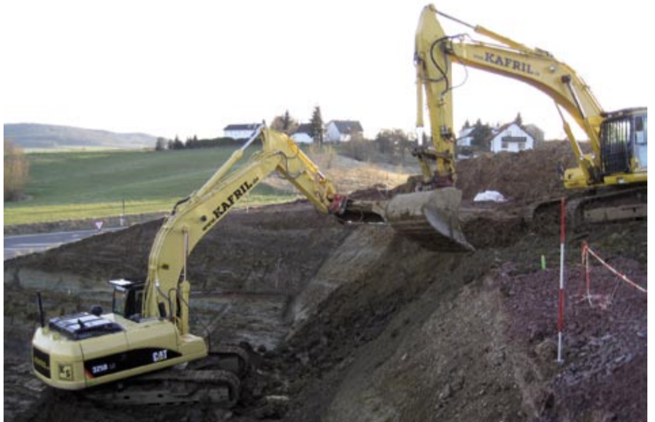
Bagger in den Größenordnungen 25 bis 40 Tonnen, darunter ein Cat 330, Cat 325, Cat 315 und Radlader Cat 962 hat das Unternehmen ebenso im Einsatz wie Dumper für den baustelleninternen Transport. Fotos: Kafril
