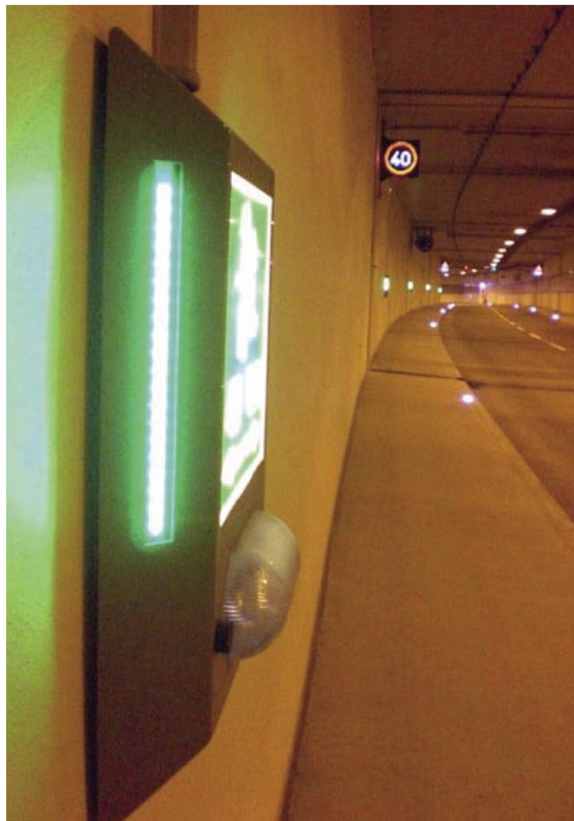
Die Brandnotleuchten aus dem Hause Cegelec bieten Sicherheit.
