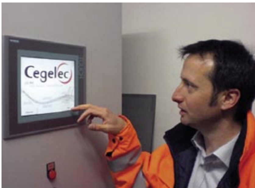
Cegelec-Projektmanager Jens Starke an der von Cegelec installierten Beleuchtungssteuerung des Tunnels. Fotos: Cegelec
