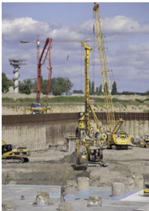
Die Baustelle für den neuen Hauptstadt-Airport BBI: Dutzende Kräne, Bagger und andere Baumaschinen müssen täglich sorgfältig koordiniert werden, um einen reibungslosen Bauablauf zu gewährleisten. Foto: Marion Schmieding / Alexander Obst
