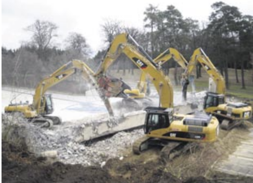
Die Fußgängerbrücke war zwar stärker bewehrt als es den Anschein machte, aber die Cat-Kettenbagger zwangen sie dennoch in der vorgegebenen Zeit in die Knie.
