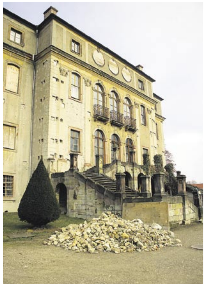
Größte Herausforderung für Denkmalpfleger und Handwerker war die Wiederherstellung der imposanten Freitreppe vor dem Schloss mit der Rekonstruktion von gusseisernen Elementen des barocken Treppenlaufes.
