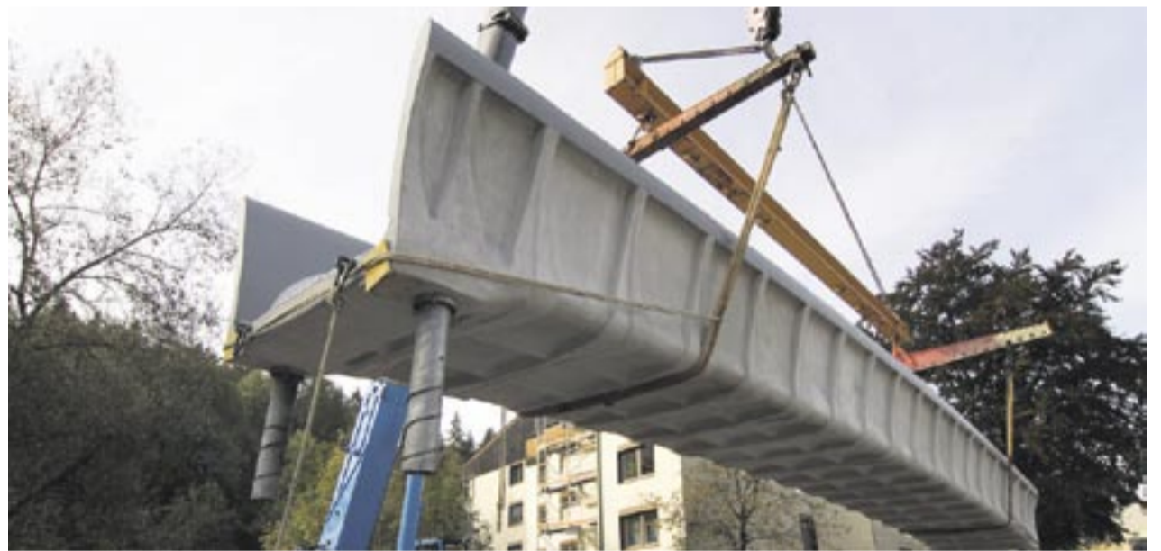
Eine Brücke aus Textilbeton verbindet in Kempten seit Oktober letzten Jahres die beiden Ufer der Rottach. Die Brücke ist die zweite ihrer Art - und sie ist nahezu doppelt so lang wie das Vorgängermodell im sächsischen Oschatz: Die aus 18 Segmenten zusammengesetzte Brücke erreicht eine Gesamtlänge von 16,74 Metern. Foto: Ulrich van Stipriaan
