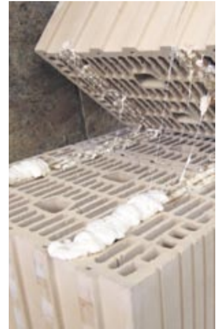
So sieht es aus, wenn Mauersteine mit PU-Schaum aus der Dose verklebt werden. Unter Last ist die Verformung in einer solchen Fuge etwa 30 Mal höher als bei mineralischem Mörtel. Foto: IWM
