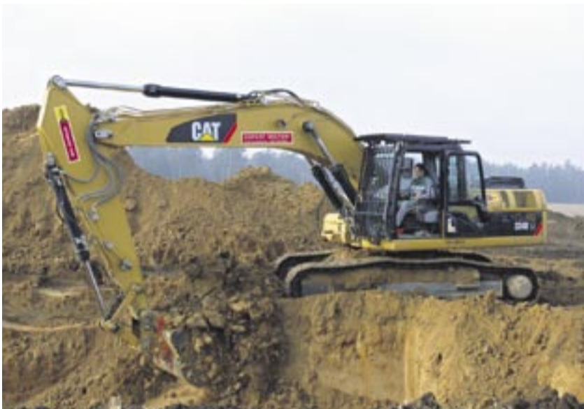
Im Zuge der Oberflächenentwässerung des Grundstücks werden Gruben für ein mehrstufiges Beckensystem ausgehoben.
