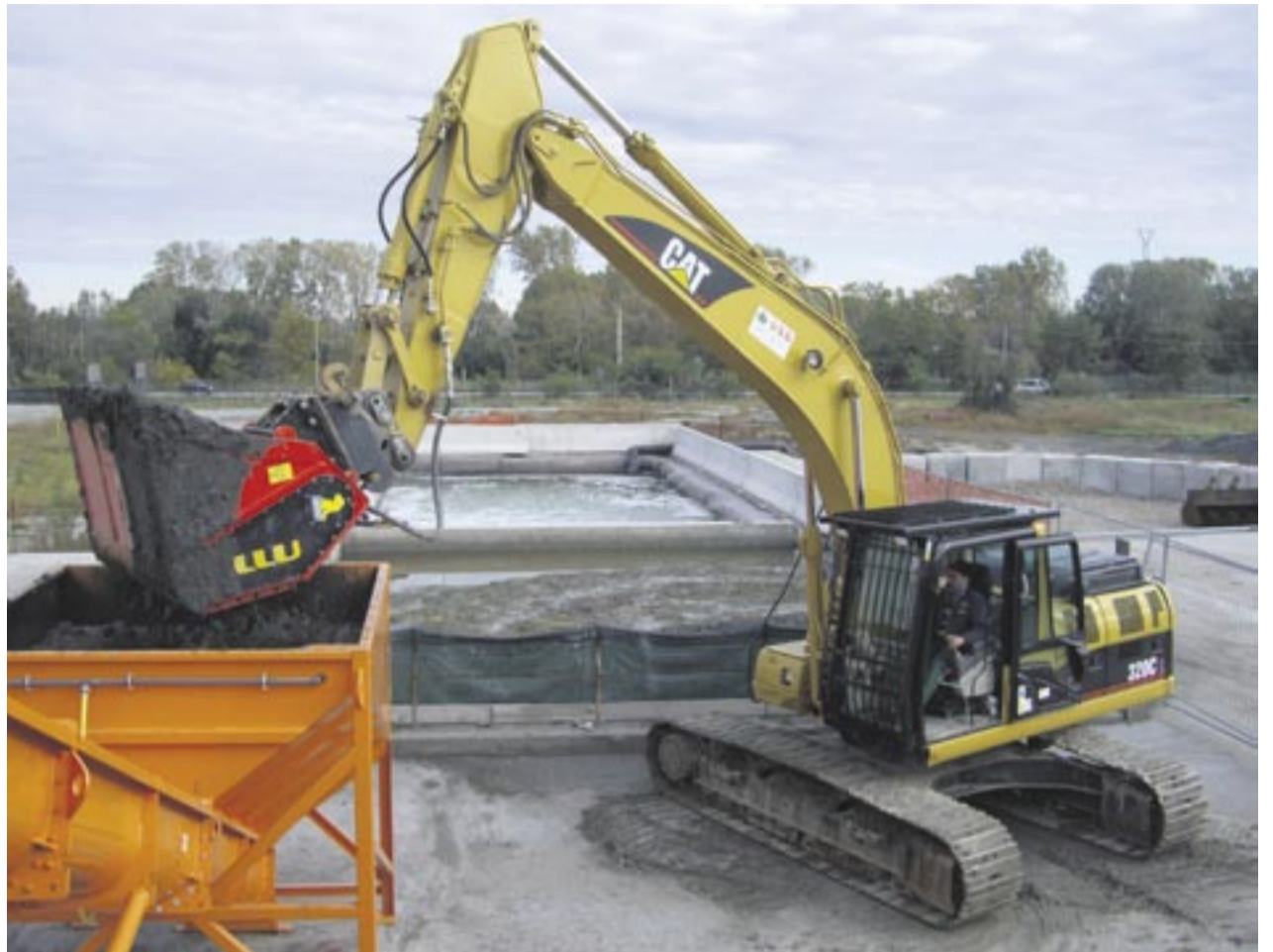
Der Cat-Bagger 320 C beschickt mit einer Separatorschaufel die mobile Aufbereitungsanlage in Venedig, damit der Lagunenschlamm gereinigt werden kann. Fotos: USG
