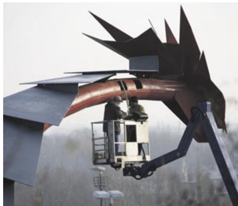
Montiert wurden die Schwingungstilger bereits bei der Fertigung des stählernen Drachenhalses. Vor Ort erfolgte die Feinjustierung und über „Kiemenklappen“ künftig auch die Wartung.
