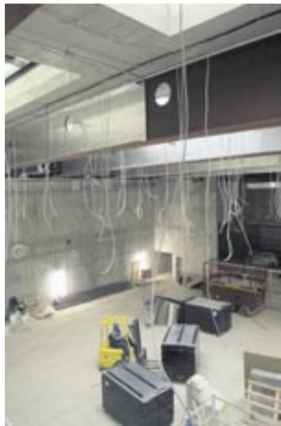
Selbsttragende mit einer gitternetzverstärkten Aluminiumfolie kaschierte Steinwolle-Platten erhalten die statischen Kräfte aller Stahlträger im Gebäude wie hier in den beiden großen Veranstaltungssälen des Hotels im Falle eines Großbrandes.
