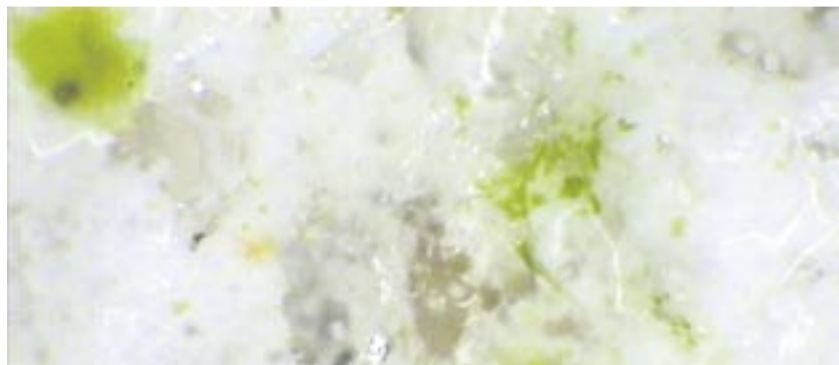
Makroskopische Aufnahme eines Putzes mit Algenbefall.
