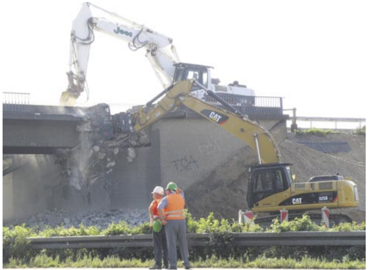
Innerhalb kürzester Zeit brach die Firma Joos Umwelttechnik mit vier Cat-Baggern eine Autobahnbrücke in der Nähe von Freiburg ab. Zwei Geräte vom Typ 325D hatte sich Joos mit Fahrer von der Firma Hoch Baumaschinen aus Steinach gemietet. Foto: Zeppelin
