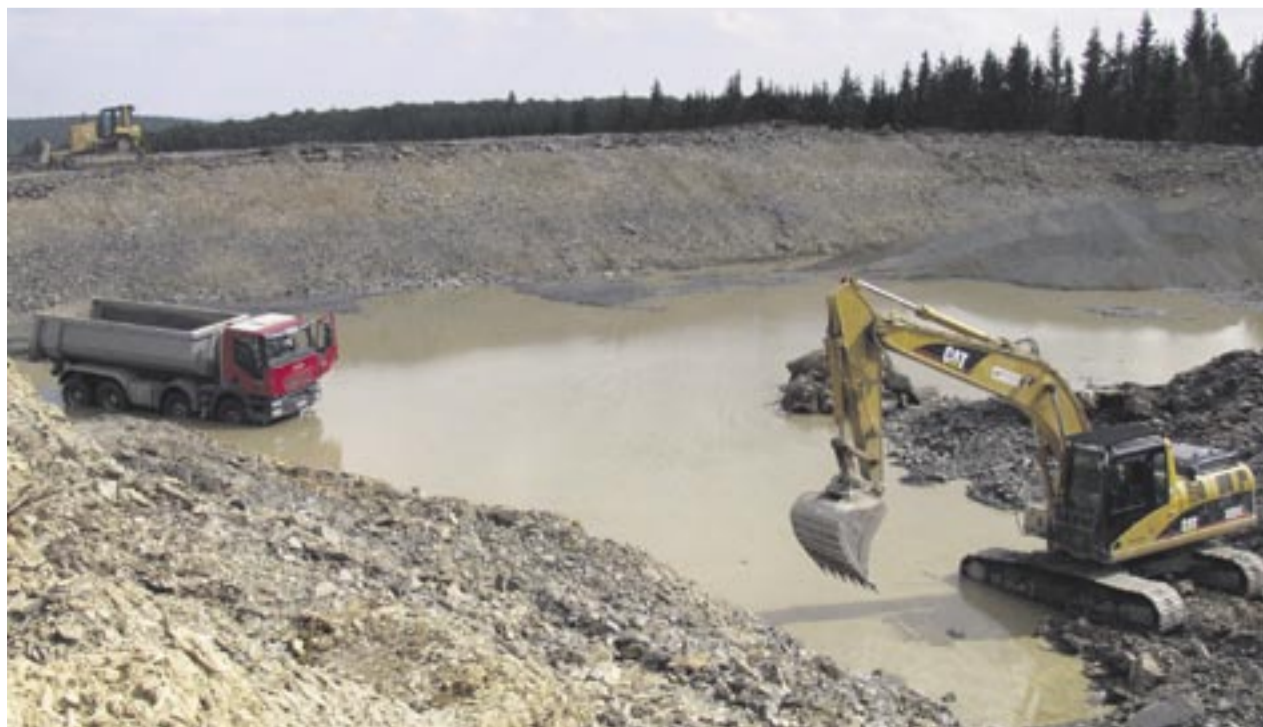
Aus dem Speichersee wird diesen Winter die Beschneiungsanlage gespeist. Foto: Ulrike Schiefner
