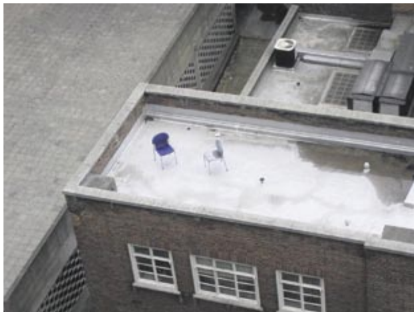
Schäden auf dem Dach wegen unsachgemäßer Nutzung.
