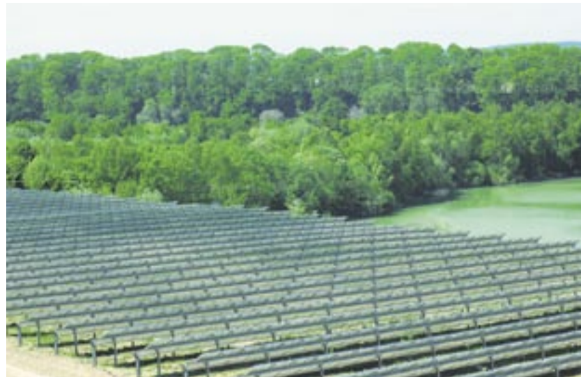
Mit 3,5 Hektar die größte Solaranlage Oberschwabens, die in der ehemaligen Kiesgrube der Firma Röhm eröffnet wurde. Fotos: ISTE
