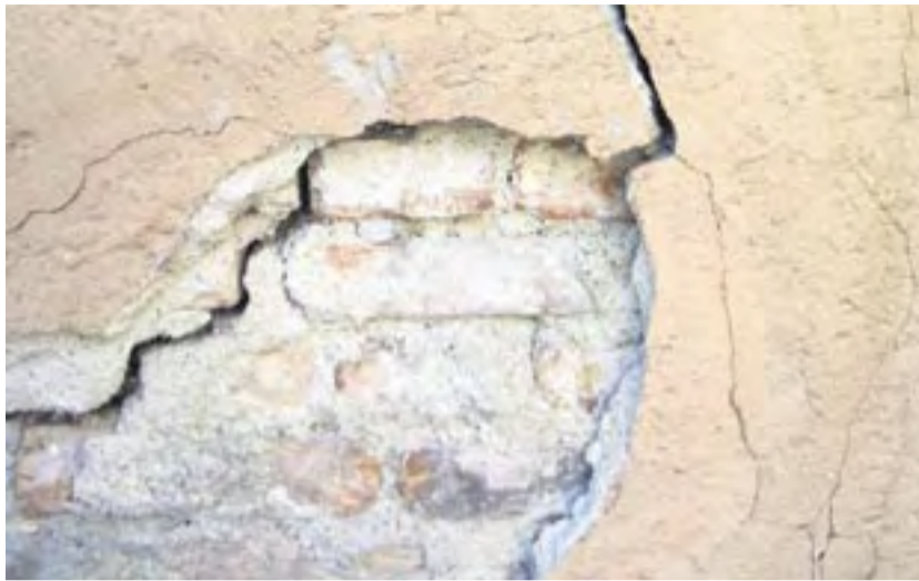
So entsteht ein Schaden: Erst sind es kleine Risse im Putz, dann fällt der Putz ab und das Mauerwerk tritt hervor. Eindringendes Wasser gibt dem Bauwerk dann den Rest.
