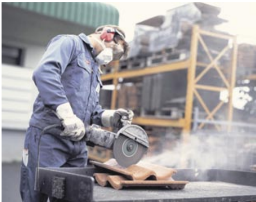
Zu viel Staub auf der Baustelle ist schädlich. Foto: Berufsgenossenschaft der Bauwirtschaft
