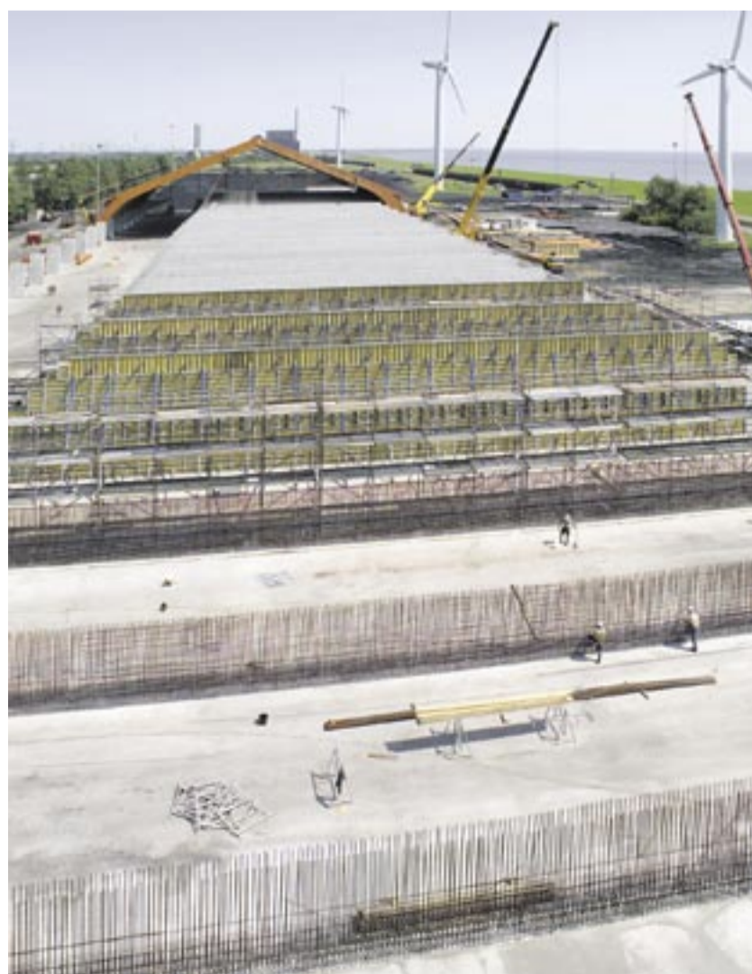
Die hauptsächlichlichen Schalarbeiten fanden an den 7,50 Meter hohen und 50 Meter langen Schottwänden statt.
