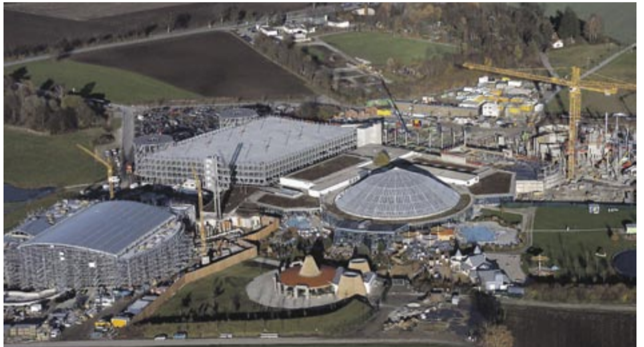
35 Firmen, mehr als 300 Bauarbeiter und neun Großkräne sorgten am Schluss für viel Bewegung auf der Baustelle rund um das Foyer, dem Rutschen- und Saunaparadies der Therme Erding.
