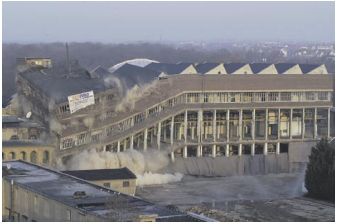
Fällt wie ein Kartenhaus in sich zusammen: das ehemalige Orsta-Hochhaus.
