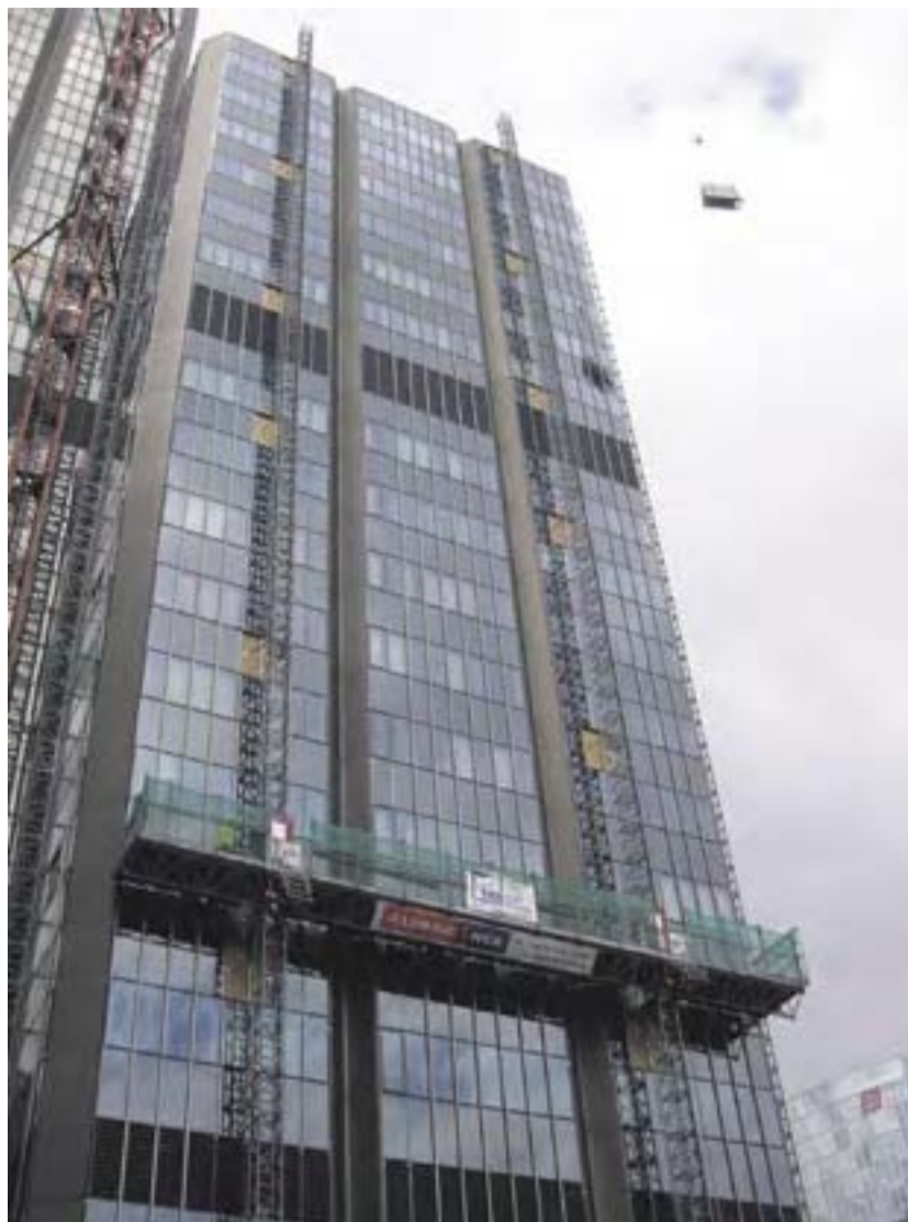
Der Gebäudekomplex der Deutschen Rentenversicherung Rheinland erhielt eine Fassadensanierung mit Mastkletterbühnen. Fotos: Alimak Hek
