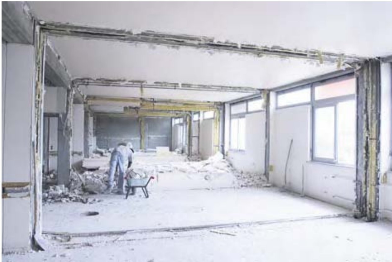
Im Zuge der Sanierungsmaßnahmen im St. Vincenz-Hospital in Brakel wurden insgesamt vier Stationen komplett entkernt. Die neue Raumaufteilung wurde anschließend mit Trockenbausystemen von Rigips umgesetzt. Fotos: Rigips
