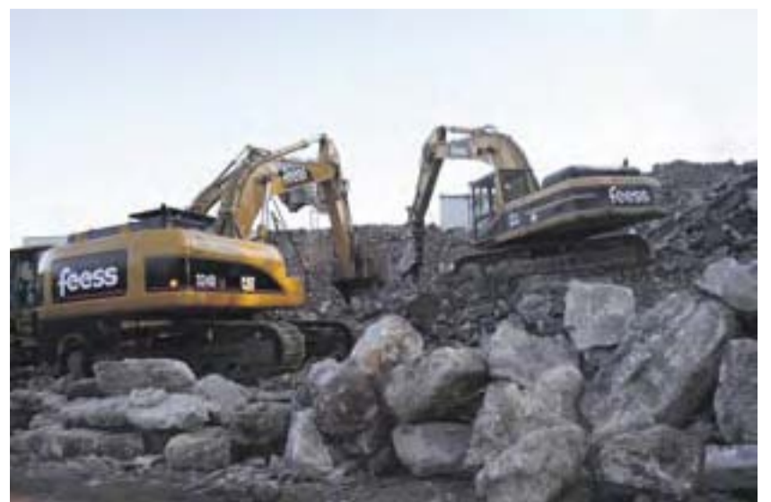
Alt und neu vereint: Das Recycling von Bauschutt bewältigen unter anderem zwei Cat-Kettenbagger.
