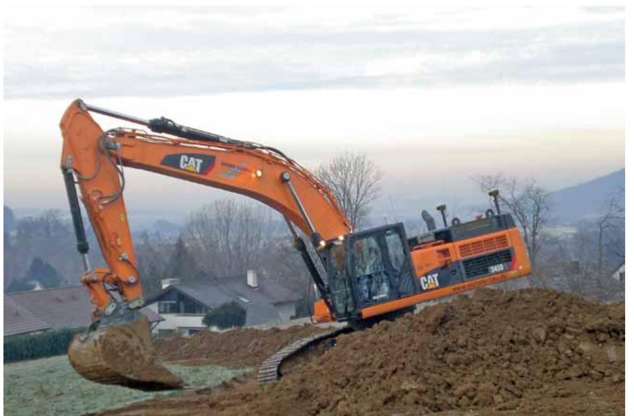
Rund ein Drittel aller Baustellen wickelt die Baufirma Eichele mit Steuerungen ab. Deren Auslastung beträgt bei den Dozern rund 90 Prozent und bei den Kettenbaggern 70 Prozent. Foto: Sitech Deutschland
