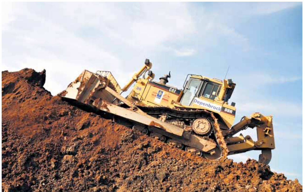
Im Fall der neuen Cat Raupe D6T samt klappbarem Dreiwegschild und Moorlaufwerk musste die Baumaschinen erst einen Testeinsatz in Heidelberg bei der Erschließung eines großen Wohngebietes bestehen.
