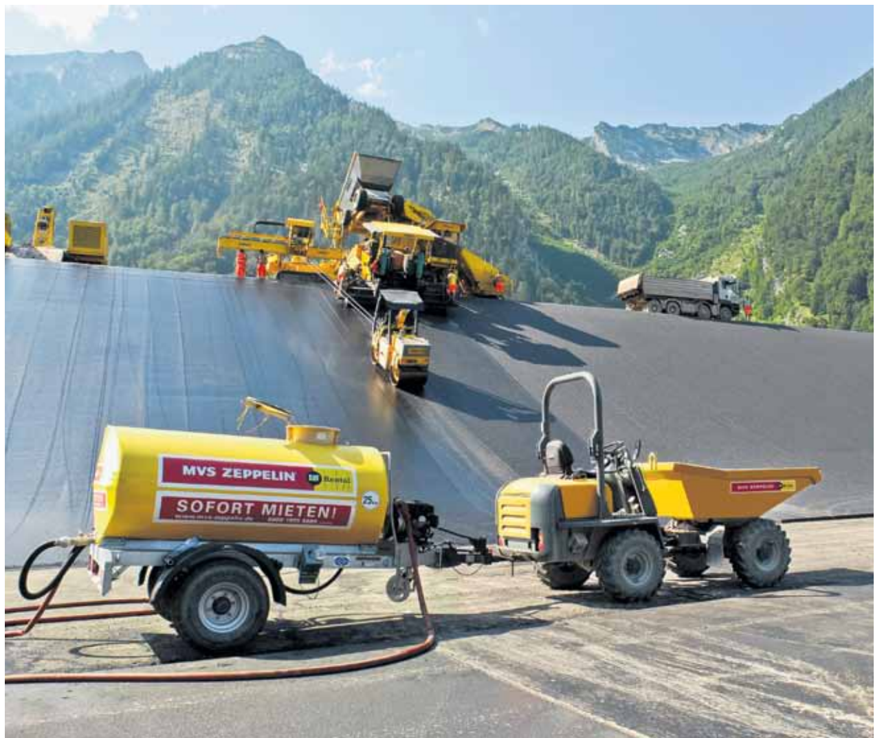
Insgesamt trug Walo mithilfe von MVS Zeppelin Österreich im Wagspeicher Hieflau etwa 82 000 Tonnen Asphalt auf einer Fläche von 185 000 Quadratmetern auf. Foto: MVS Zeppelin
