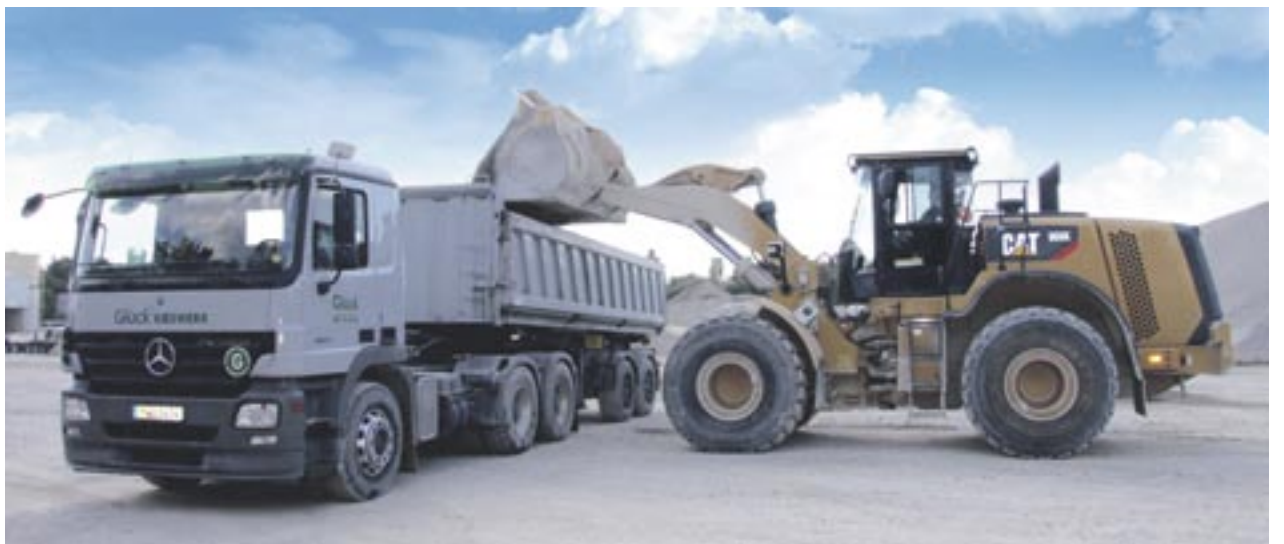
Mehrere Wochen hat bei der Firma Glück ein getarnter 966K Kies, Sand und Splitt auf eigene Lkw sowie Kunden-Lkw verladen. Fotos: Zeppelin
