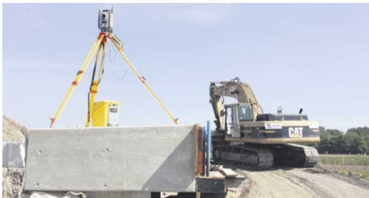
Ebenfalls auf der A5 im Einsatz ist ein Cat 330, der Durchlässe anlegt oder Baugruben für Betonsäulen aushebt.
