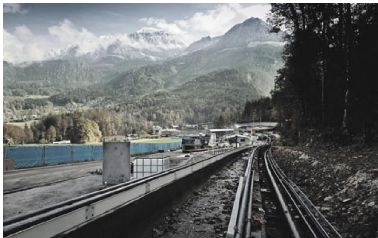
Während der letzten sieben Monate haben die Facharbeiter von ThyssenKrupp Xervon über 30 Kilometer Rohre und fast 600 Armaturen an der legendären Bob- und Rodelbahn am Königssee verlegt. Foto: ThyssenKrupp Xervon
