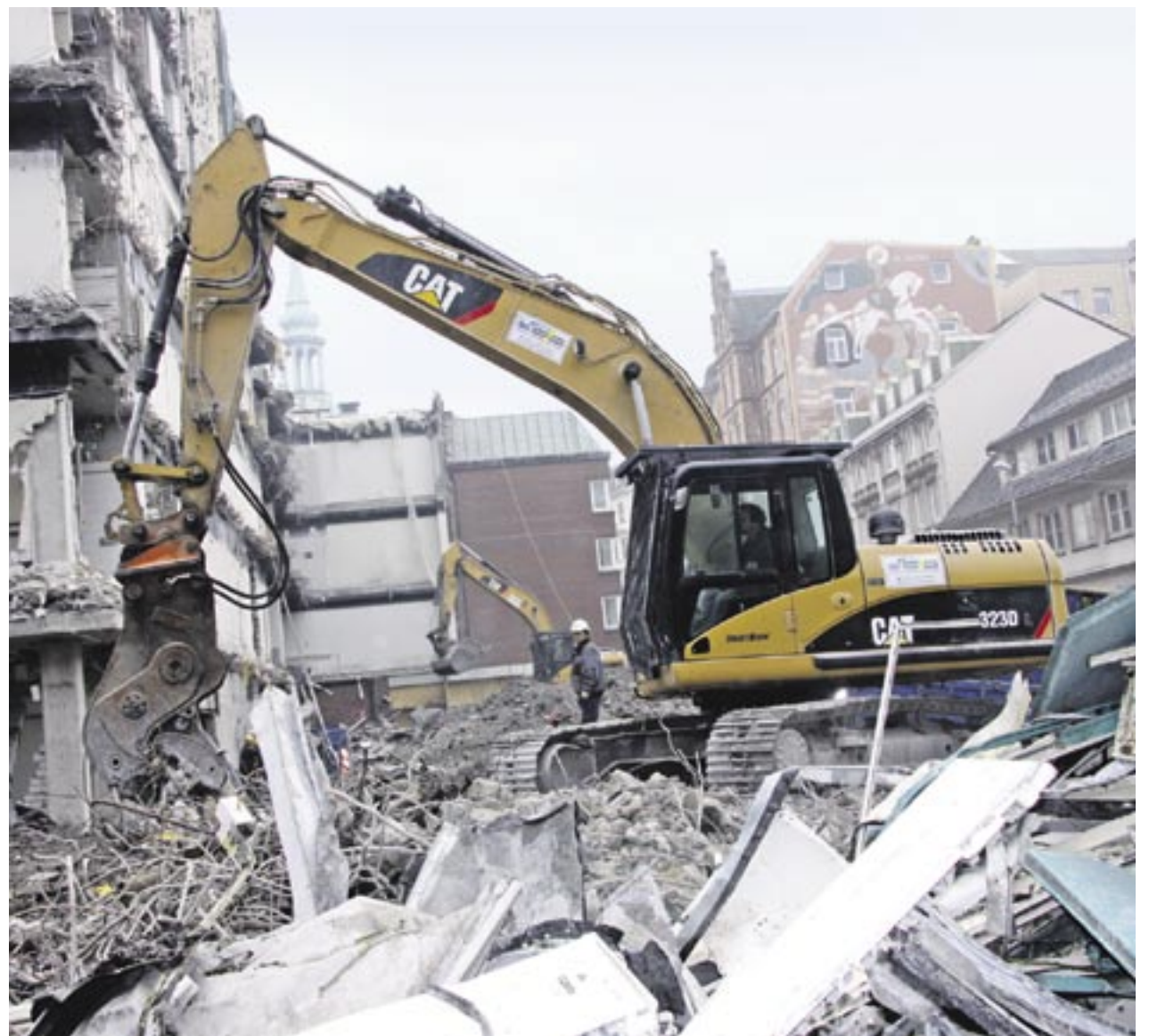
Der beim Abbruch anfallende Bauschutt, wie Stahl, Beton und Mauerwerk, wird von zwei Cat Kettenbaggern 323DL sowie dem Cat Kettenbagger 311 grob vorsortiert, auf Halden aufgeschichtet und dann auf Lkw verladen.
