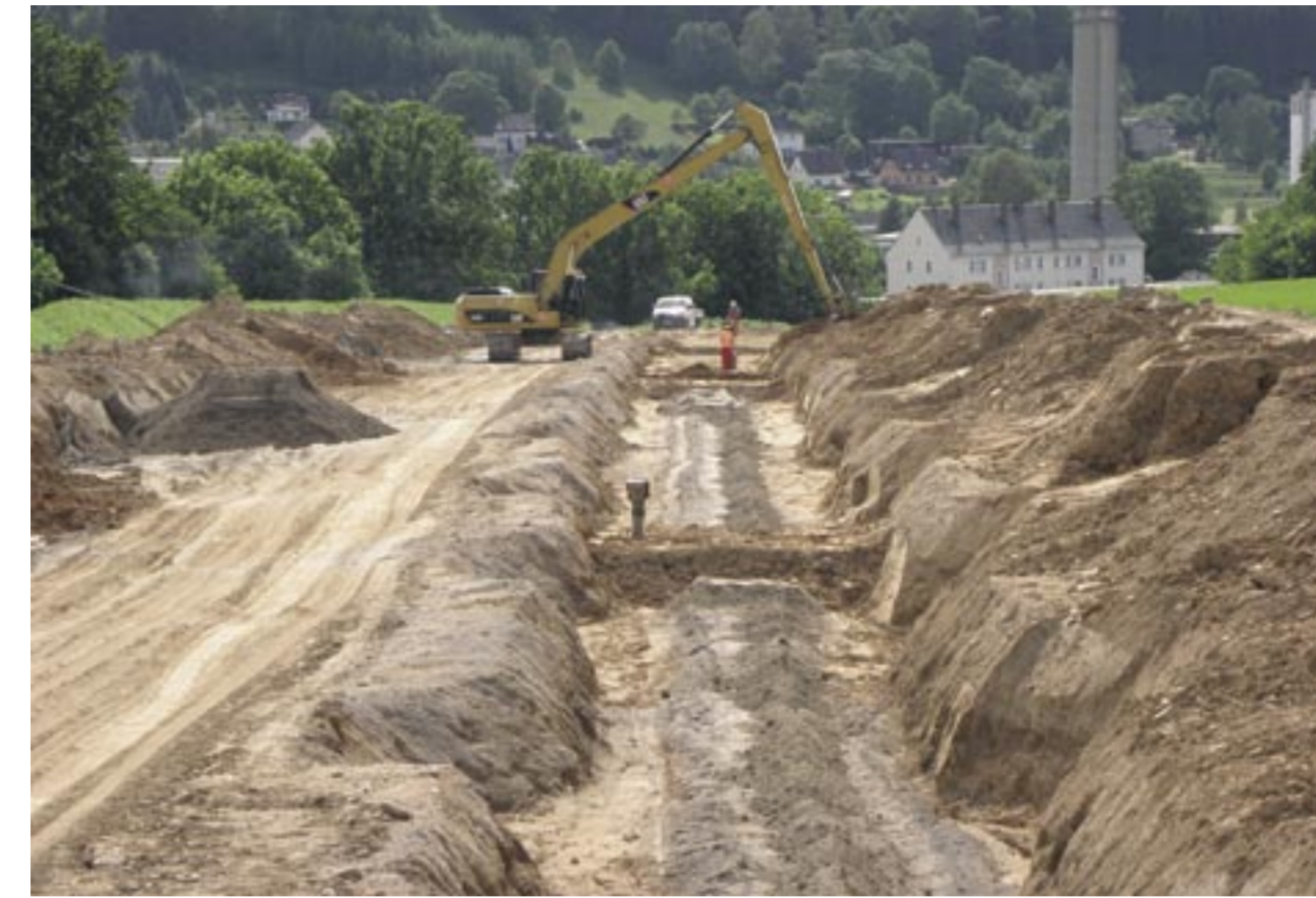
Anschließend wird die ausgehobene Erde wieder über die Pipeline verteilt und dann der Mutterboden aufgetragen.
