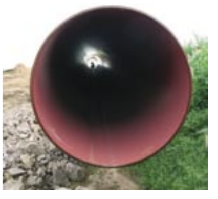
Die Rohre haben einen Durchmesser von 1,40 Meter.
