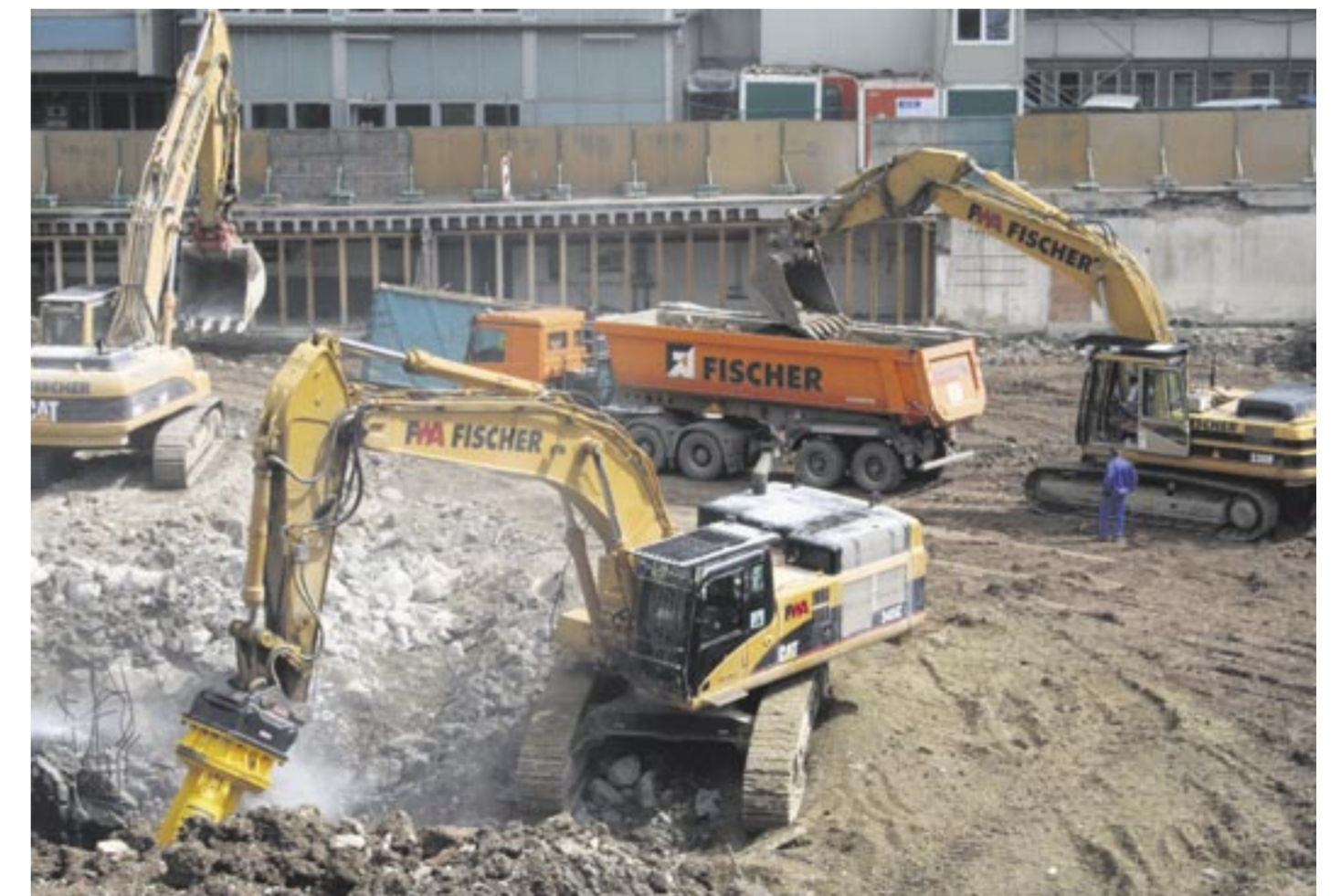
Entsprechend knifflig war und ist es, die Baustellenlogistik auf dem Areal einzurichten, die Materialabtransporte von Abbruchmaterial wie Stahlbeton und Mauerwerk im innerstädtischen Bereich zu organisieren sowie den Einsatz von Cat Baumaschinen und Lkw auf engem Raum zu koordinieren.
