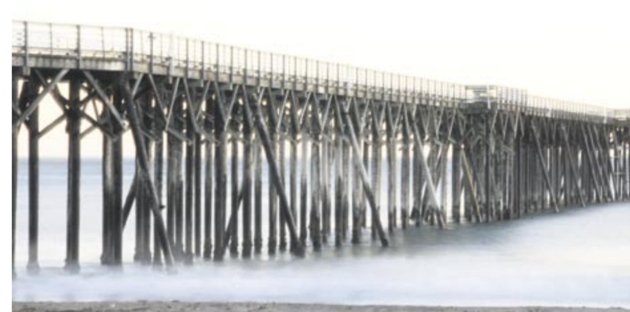
Über 26 Prozent der Brücken sind akut sanierungsbedürftig.
