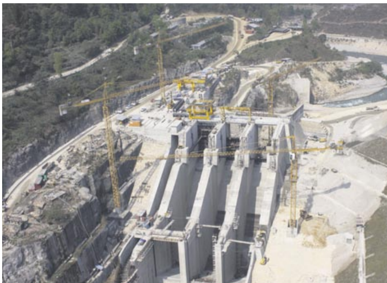
Das Middle Marsyangdi Wasserkraftwerk besteht aus einer Vielzahl von Bauwerken, die teilweise unterirdisch, teilweise über der Erde liegen.
