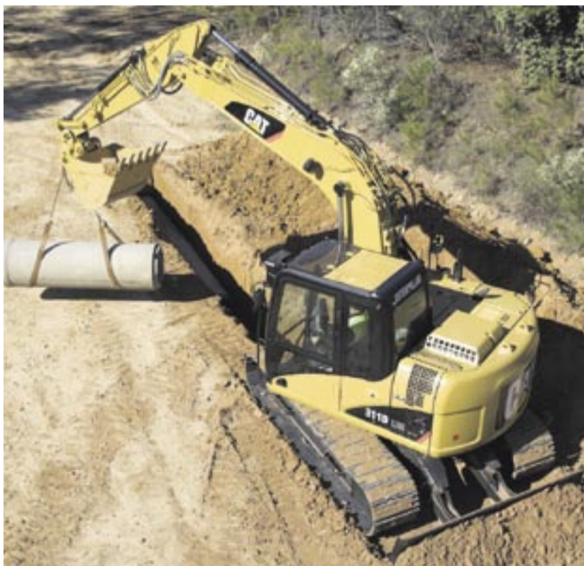
Ein neues Schmuckstück von Cat, das dem Fahrer ein schnelles und effektives Arbeiten ermöglicht und für den Unternehmer die Kosten senkt. Foto: Zeppelin
