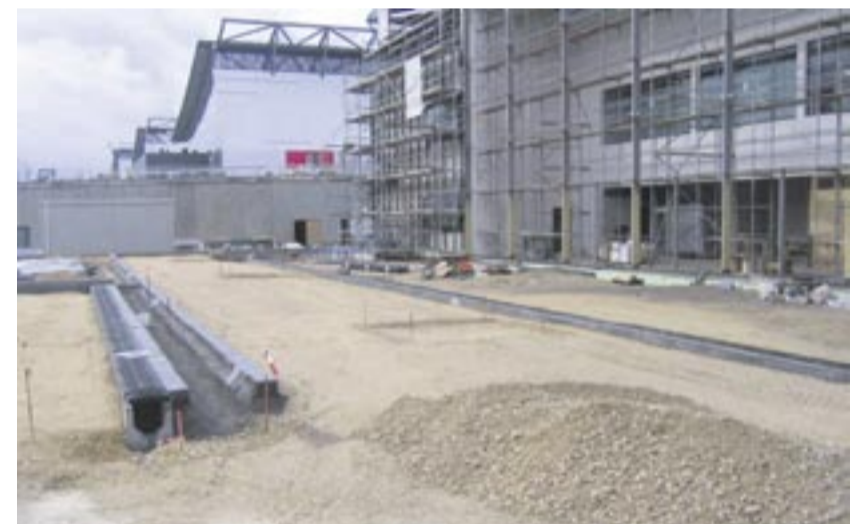
Das Rinnensystem zur Entwässerung auf der Messepiazza. Foto: Birco
