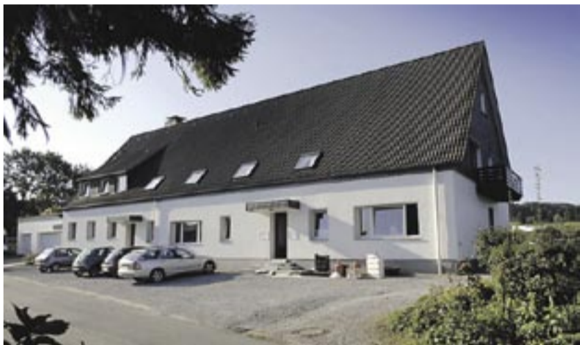
Dauerhaft trocken gelegt, sind die Mauern der 1945 errichteten Scheune, die 30 Jahre später zum Wohnhaus umgebaut wurde. Fotos: Isotec
