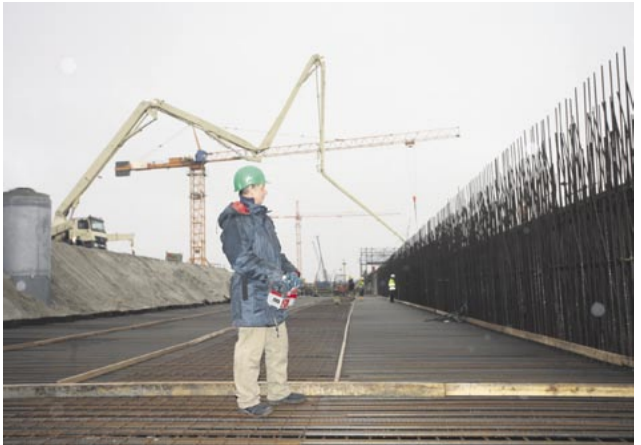
Die Maschinisten haben die Einbaustellen jederzeit im Blick. Muss der Endschlauch durch die enge Armierung gefädelt werden, ist eine feinfühlig ansprechende Funkfernsteuerung von Vorteil. Foto: Putzmeister
