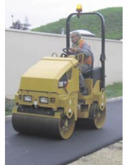
Kompakt und wendig: Die neuen Tandemvibrationswalzen CB14 gibt es in vier verschiedenen Modellen, die sich unter anderem durch den größten Wassertank ihrer Klasse und durch innovativ konstruierte Bandagen auszeichnen.
