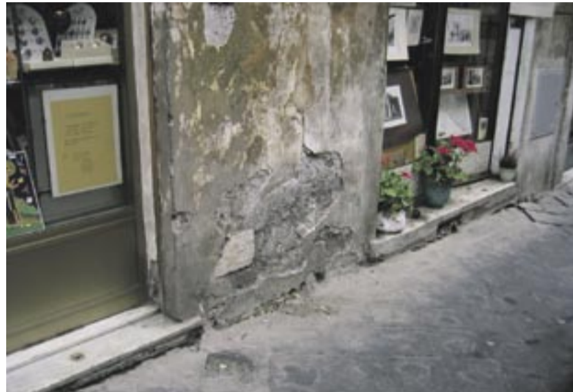
Feuchte Mauer müssen nicht mehr unbedingt in teure Sanierung ausarten.
