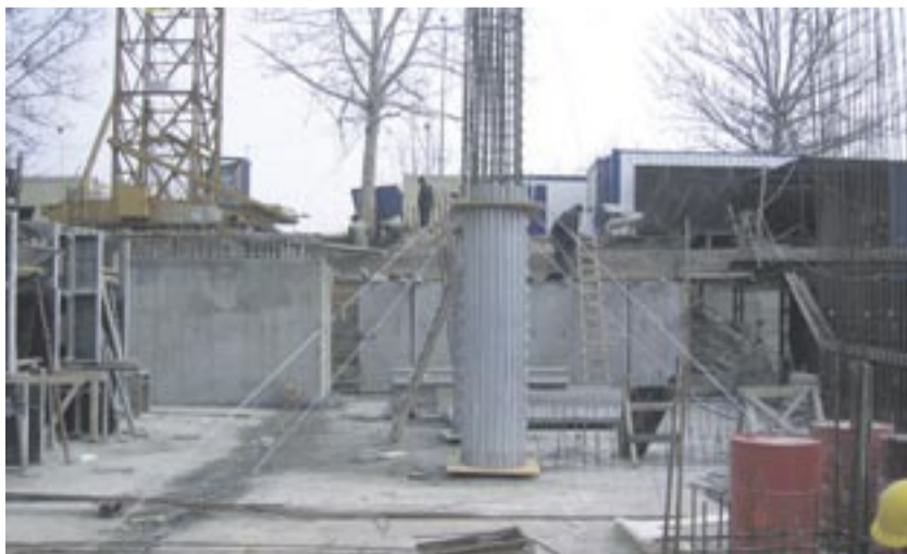
Eine relativ kurze Bauzeit, hohe Anforderung an die Qualität des Sichtbetons sowie eine Bauweise, die den seismischen Anforderungen Rechnung trägt. Das waren die Rahmenbedingungen für den Bau des vom renommierten Wiener Architekten Martin Kohlbauer entworfenen „Atrium Belgrad Offices“. Foto: NOE-Schaltechnik, Süssen
