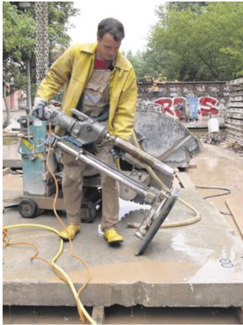
Eine abgebaute Betonplatte wird dafür vorbereitet, in einem Einfamilienhaus wieder verbaut zu werden. Foto: TU-Pressestelle/Böck
