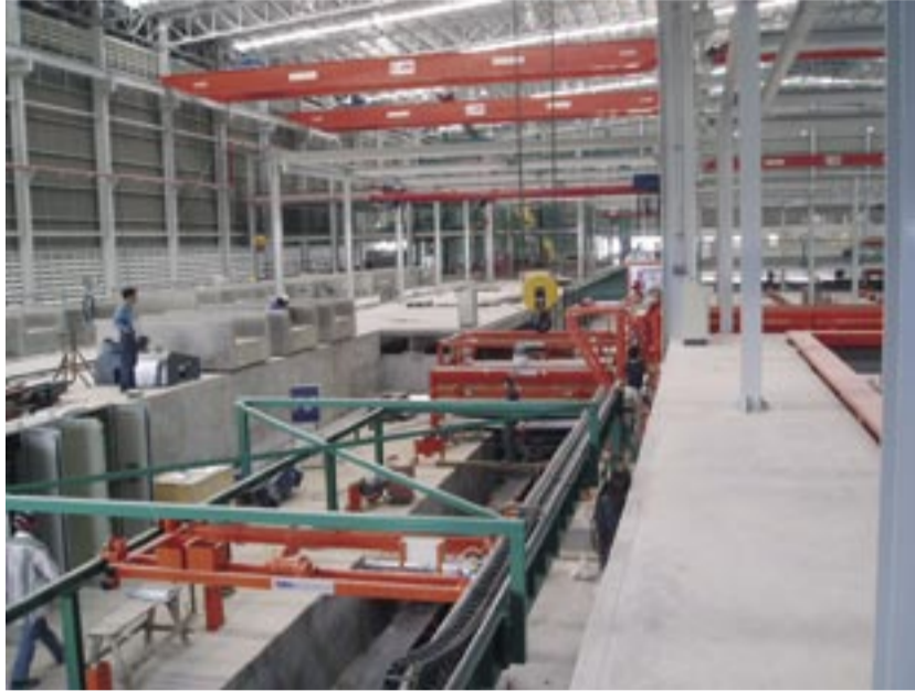
Fertigteilwerk von Preuksa in Bangkok, Thailand.
