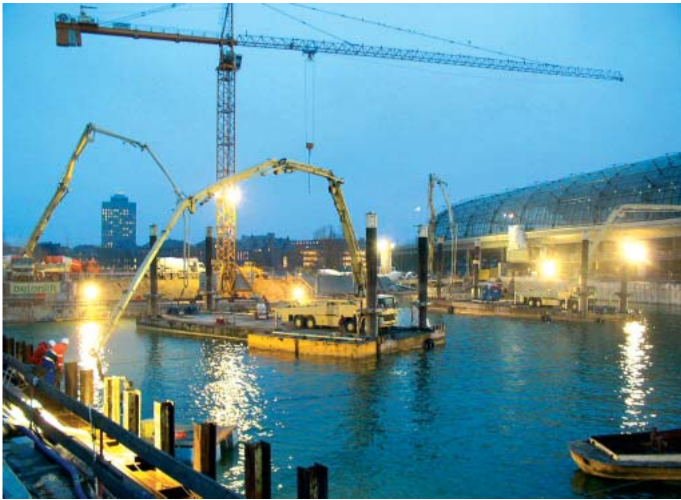
Mehr als drei Tage und Nächte, insgesamt 79 Stunden dauerte das Betonieren der letzten großen Unterwassersohle für den Lehrter Bahnhof in Berlin.
