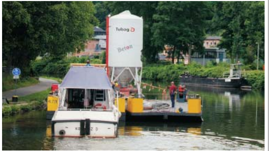
Schleuse Lahnstein: Von einem Ponton aus wurde die Baustelle mit Unterwasserbeton versorgt.
