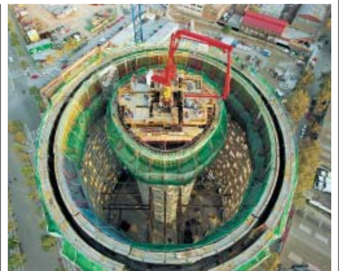
Das Selbstklettersystem „ACS-P“ trägt neben Schalungen, Arbeitsgerüsten und -geräten auch den Betonverteiler von Etage zu Etage mit nach oben.
