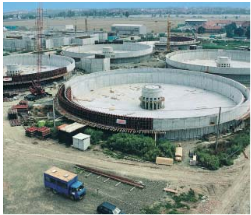
Nach dem Neubau und der Modernisierung wird sie das größte Klärwerk dieses Typs in Europa sein: die Abwasserkläranlage im tschechischen Brünn.
