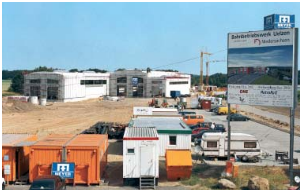
Für den in nur 11 Monaten zu realisierenden 25-Millionen-Euro-Neubau des Bahnbetriebswerks in Uelzen bekam Meyer 2003 den Zuschlag als Generalübernehmer. Die Kompetenz mit allen eigenen Sparten sowie nachgewiesene Flexibilität und Qualität bei Großprojekten dürften den Auftraggeber Ostthannoversche Eisenbahn AG überzeugt haben.
