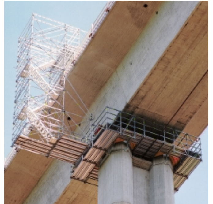
Über die integrierte Gerüsttreppe am fahrbaren Hängegerüst gelangen die Monteure sicher auf die „Peri Up“-Arbeitsplattformen, die an den Pfeilerköpfen angehängt sind.
